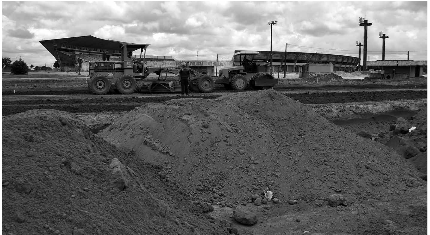
Na parte externa do estádio, as máquinas seguem realizando trabalhos de terraplanagem onde vários equipamentos serão construídos
